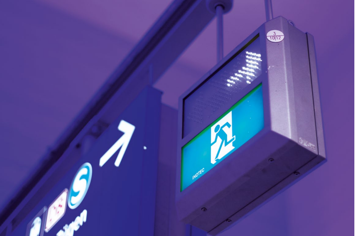
Abb. 1: Rettungswegkennzeichen mit Funktionserhalt Essen Hauptbahnhof.
