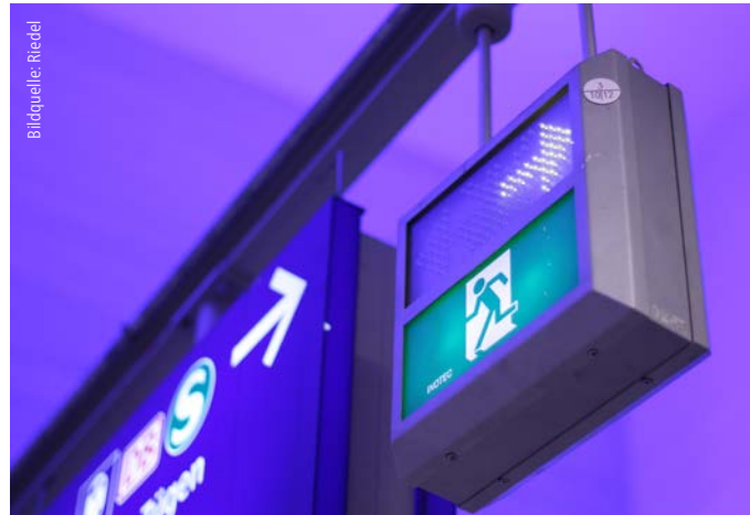
Abb. 2: Rettungswegkennzeichen mit Funktionserhalt am Hauptbahnhof Essen
